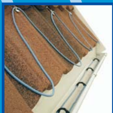
Topný kabel na okraji střechy
