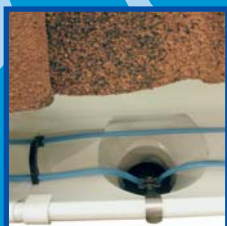
Fixace kabelu nerezovým držákem při vstupu do svodu
